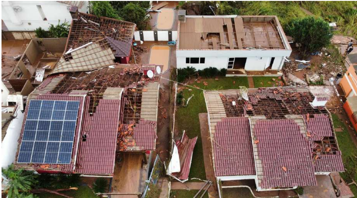
Figura 20: : Edificações afetadas pela enchente em maio de 2024 na Rua Coronel Adolfo Zimmermann, Bairro Centro - Arroio do Meio.
