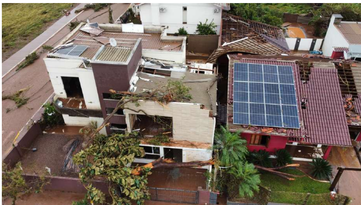
Figura 56: Registro na Rua Coronel Adolfo Zimmermann, Bairro Centro, Arroio do Meio após o evento de Maio de 2024.
