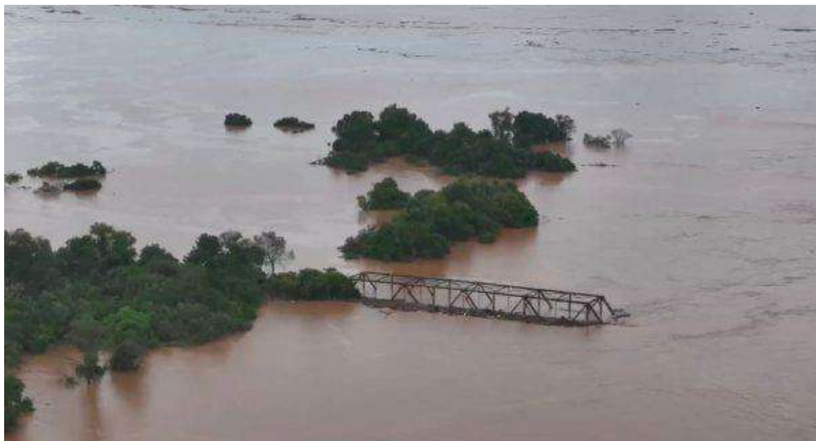
Figura 17: Ponte de Ferro entre os municípios de Arroio do Meio e Lajeado levada pela enchente.
